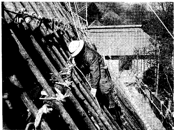
旧山下家の「ネソ巻き」 下地材の結束にはネソか縄を使うが、クダリとヤナカ（水平材）はネソ巻きで十分締め付ける。
